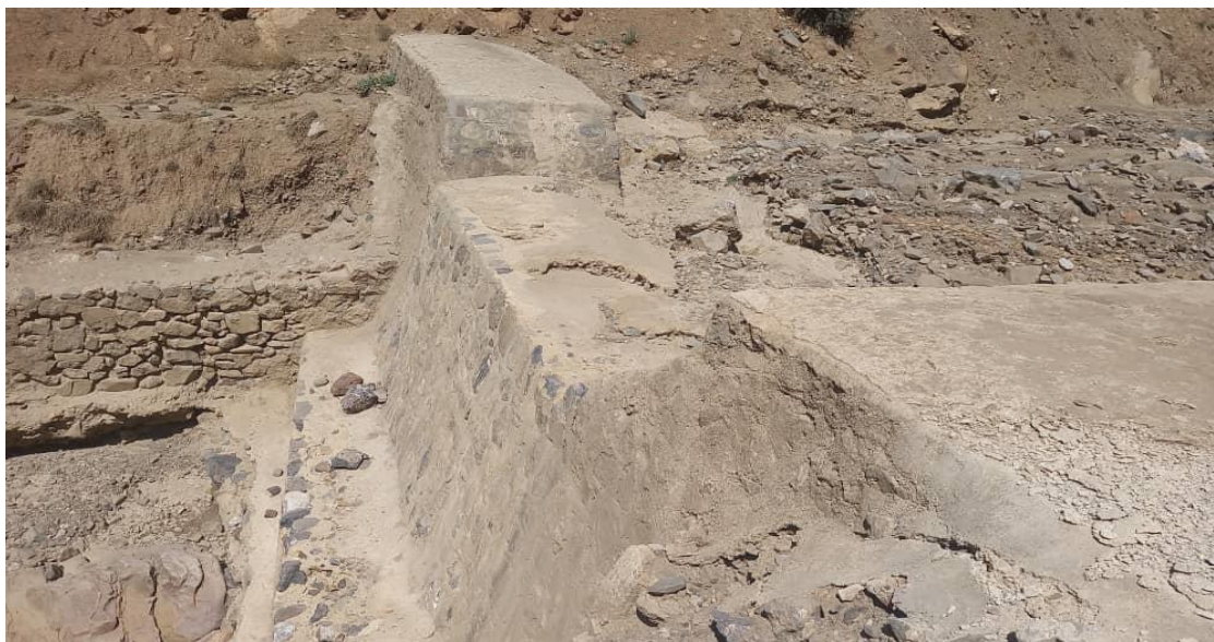
شکل ۵- سازه سنگی و ملاتی و تلفیق با سازه خشکه چینی که در مکان مناسب پیشنهاد و اجرا شده
